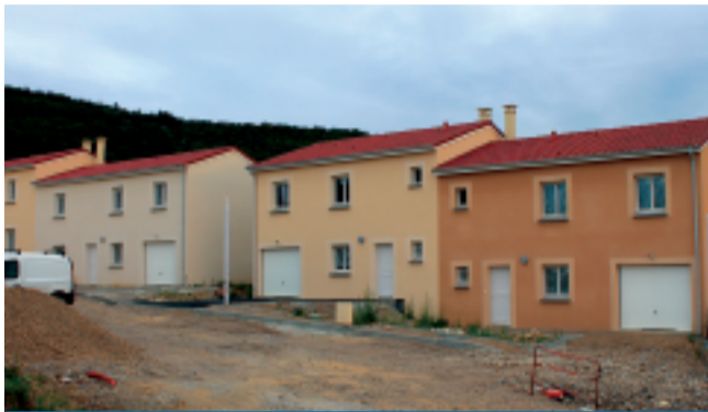
26 maisons à Félines - 36 à Annonay - 22 à Andancette et 18 à Pélussin sont en cours de construction et seront livrées entre fin 2014 et fin 2015. L'entreprise Bouygues est le maître d'œuvre.
